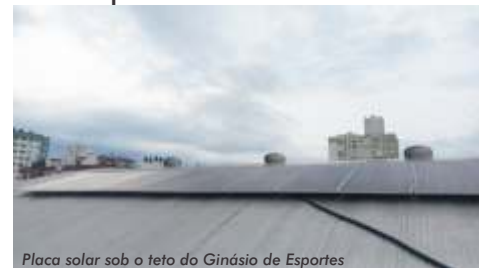
Placa solar sob o teto do Ginásio de Esportes
